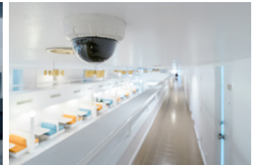
闭路电视 (CCTV)
